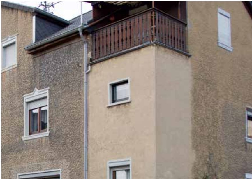
Modernisierungs- und instandsetzungsbedürftiges Gebäude mit hohem Bedarf
