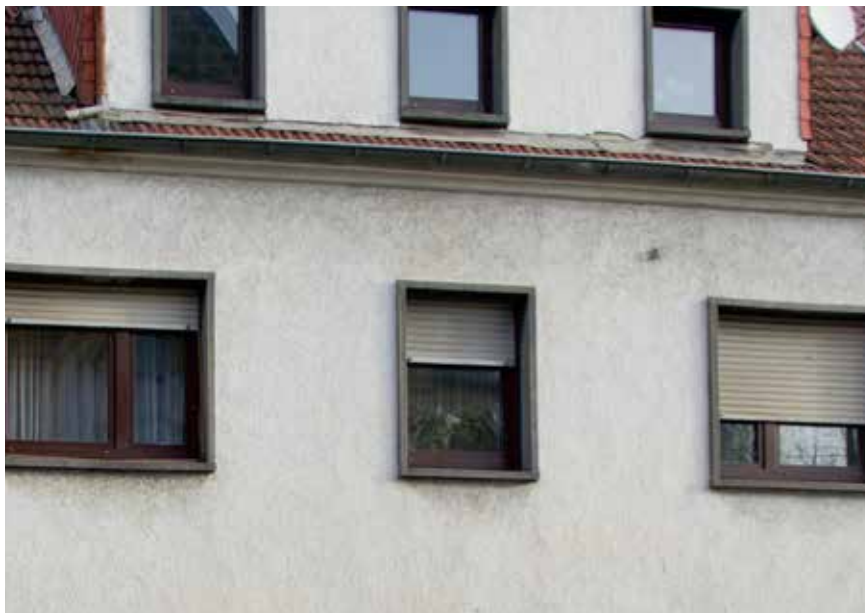
Modernisierungs- und instandsetzungsbedürftiges Gebäude mit mittlerem Bedarf
