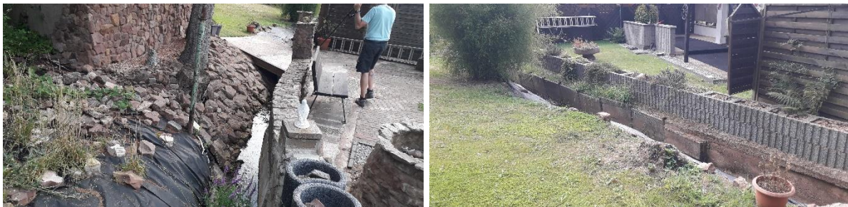
Abbildung 14: Einengungen, private Brücken und partieller Hochwasserschutz am Hahnhümes
